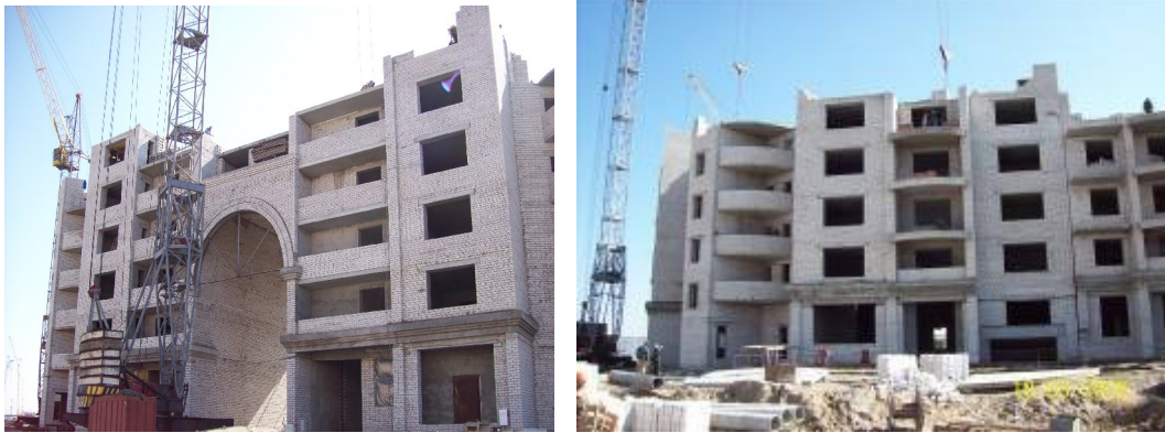
Хід будівництва мікрорайону «Ліски-2» у м. Миколаєві станом на 18.03. 2008 р. (ж/б №№ 10 та 11)
