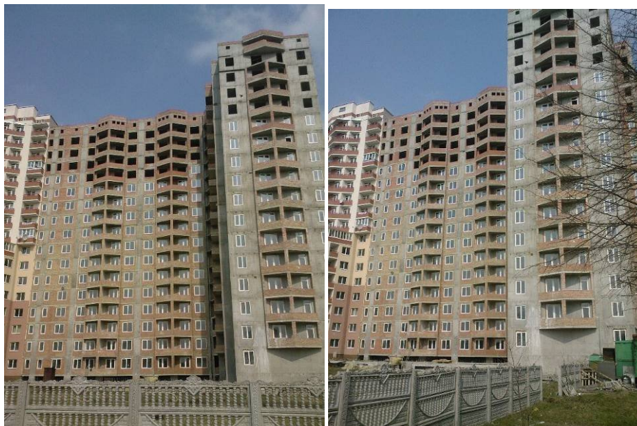
Хід будівництва багатопверхового житлового будинку з вбудованими офісними приміщеннями та підземними автостоянками по вул. Панча, 18-б у м. Львові станом на квітень 2009 року
