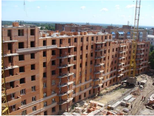
Житловий будинок по вул. Жовтневій, 40 у м. Полтаві, станом на середину червня 2009 року
