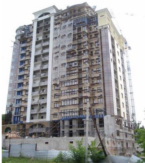
Стан будівництва житлового комплексу по вул. Фронтівій, 3 у м. Харкові станом на початок серпня 2011 року
