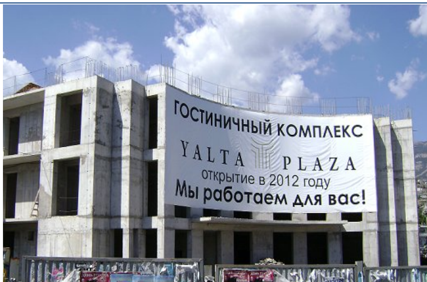
Хід робіт на об'єкті будівництва по вул. Ігнатенко, 9 у м. Ялті станом на 27.08.2010 р.
