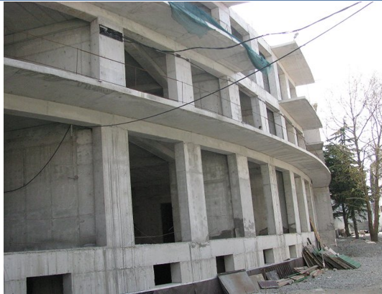
Хід робіт на об'єкті будівництва по вул. Ігнатенко, 9 у м. Ялті станом на початок травня 2010 року
