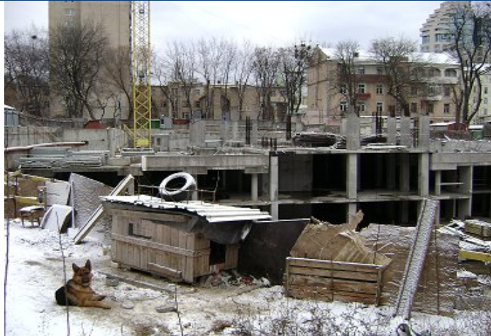
Хід робіт з будівництва багатопверхового житлового будинку з вбудовано-прибудованими приміщеннями громадського призначення та підземного паркінгу по вул. Білоруській, 36-а у Шевченківському районі м. Києва станом на 10.12.2010 р.
