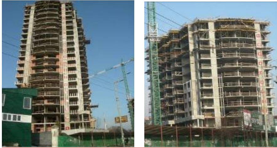
Рисунок 1.2. Хід будівництва житлового комплексу «Парк Авеню» (I черга) станом на 10.12.2008 р. (зліва-направо): будинок № 1 та будинок № 2
