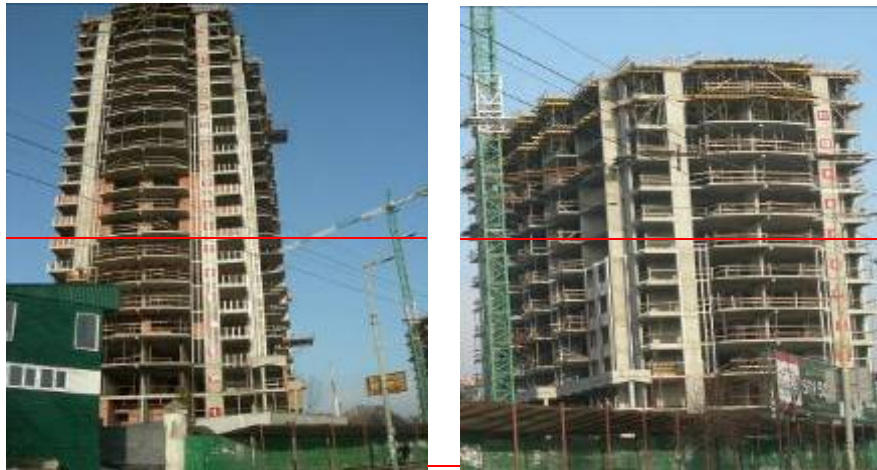
Рисунок 1.2. Хід будівництва житлового комплексу «Парк Авеню» (I черга) станом на 10.12.2008 р. (зліва-направо): будинок № 1 та будинок № 2
