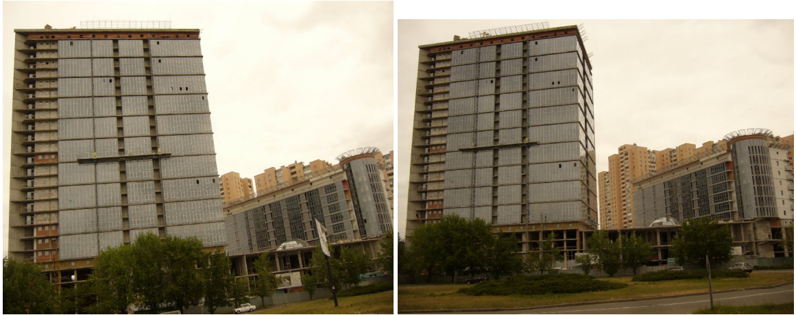
Рисунок 1. Будівельні роботи на об'єкті «Артеміда комплекс» за адресою м. Київ, перехрестя Дарницького бульвару та вул. Генерала Жмаченка станом на 01.08.2009 р.
