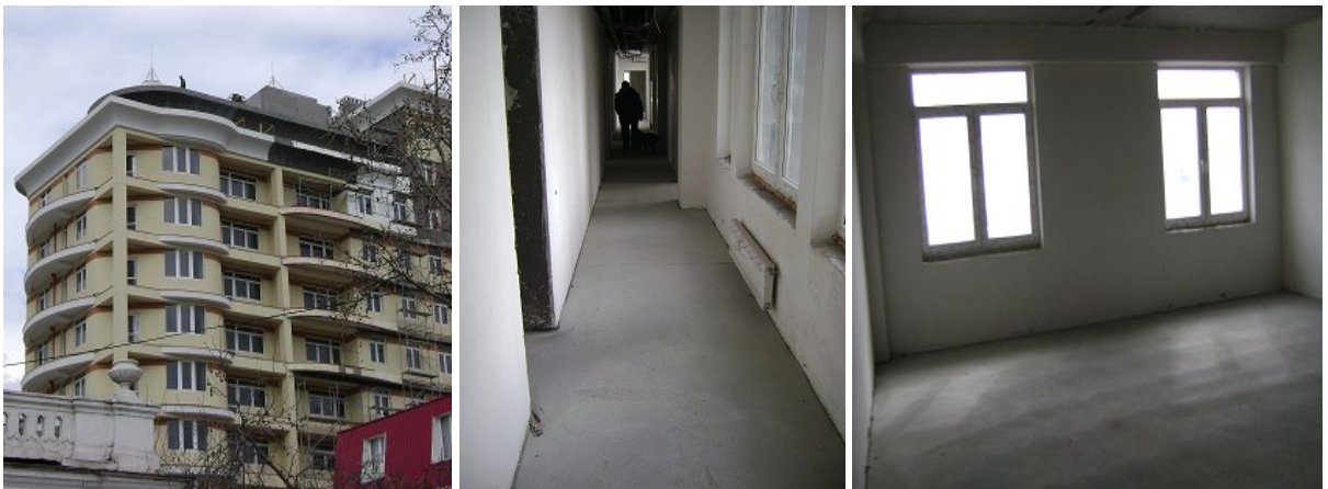
Хід робіт на об'єкті будівництва житлового комплексу «Адміралтейський» класу «люкс» по вул. Руданського, буд. 8 Б станом на 04.03.2010 р.
