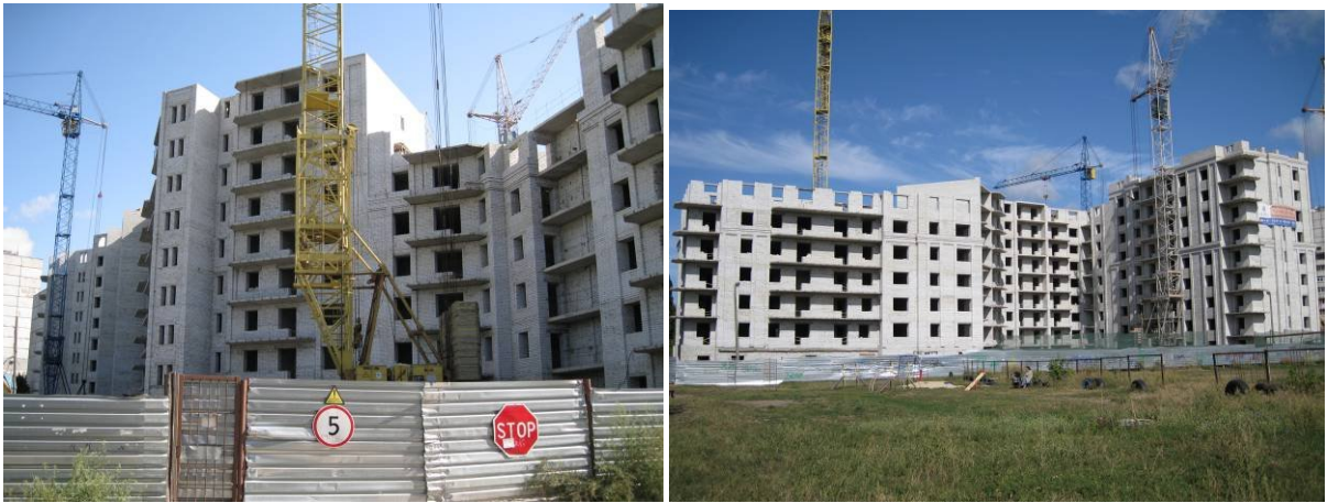
Хід робіт на об'єкті будівництва по пр. Тракторобудівників, в районі буд. 103 А у м. Харкові станом на 21.08.2009 р.
