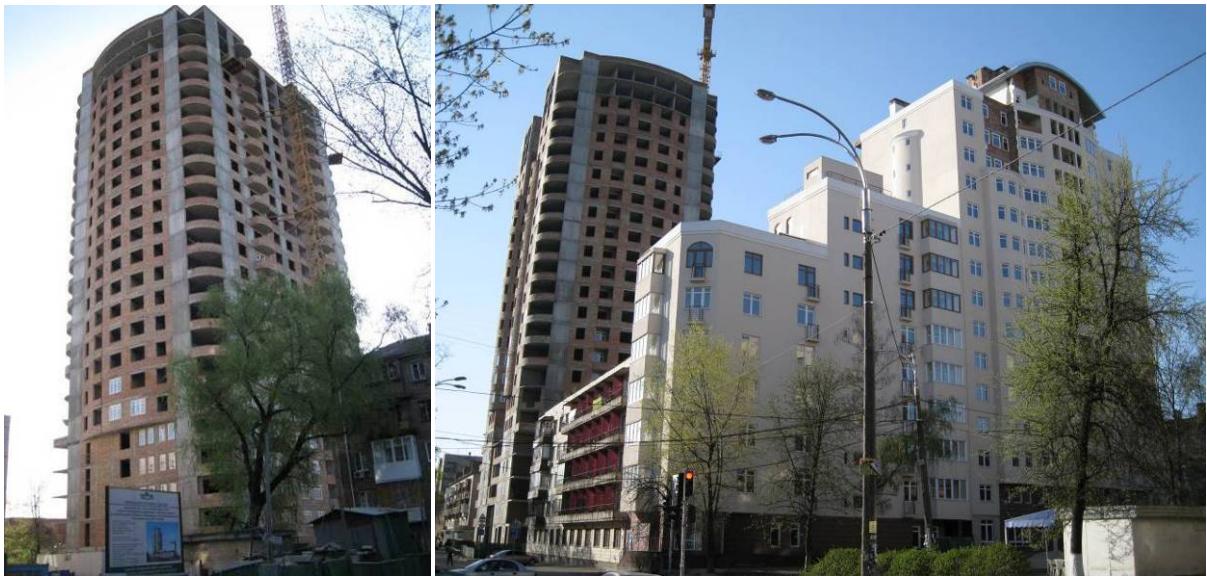
Стан будівництва житлових будинків №№1, 2, 4 по вул. М. Кривоноса та Климента на 21.04.2009 р.
