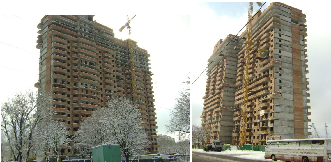
Будівельні роботи на об'єкті будівництва в м. Києві по вул. Генерала Наумова, 66 станом на 01.02.2009 р.
