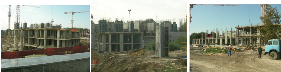
Хід будівництва другої черги (зліва – направо ж/б №6, ж/б№ 7, ж/б№ 9) житлового кварталу з об'єктами соціально-громадського призначення по вул. Професора Підвисоцького у Печерському районі м. Києва на кінець вересня 2010 р.
