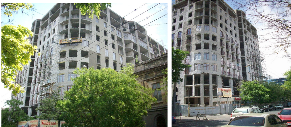
Рисунок Ошибка! Текст указанного стиля в документе отсутствует..4. Хід будівництва житлово-торговельного комплексу по вул. Грецькій, 1 у м. Одесі станом 29.05.2009 р.
