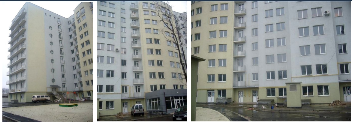
Хід робіт на об'єкті будівництва по вул. Сахарова, 82 у м. Львові станом на 27.03.2009 р.
