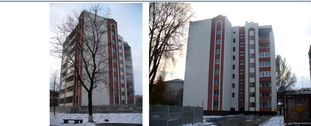
Хід робіт на об'єкті будівництва по вул. Злуки у м. Тернополі станом на 25.03.2009 р.
