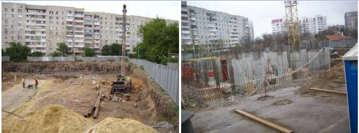
Рисунок Ошибка! Текст указанного стиля в документе отсутствует..1. Хід робіт на об'єкті будівництва по вул. Малиновського (в межах вул. Заводської та пров. Союзного) в м. Одесі станом (зліва - направо) на 16.07.2008 р. та на середину лютого 2009 р.
