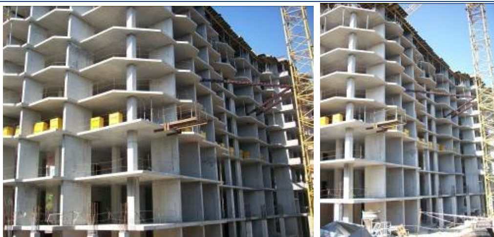
Хід робіт на об'єкті будівництва по вул. Малиновського (на розі вул. Заводської та пров. Союзного) в м. Одесі станом на початок вересня 2009 р.
