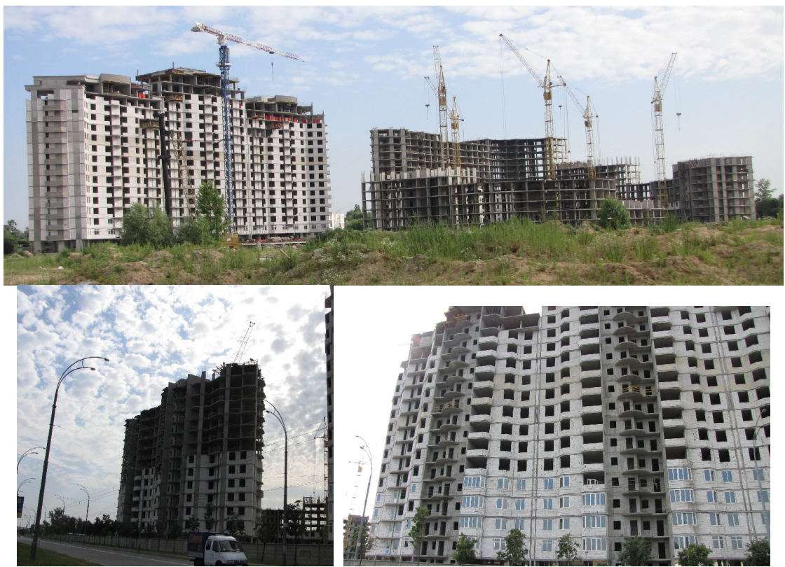
Рисунок 3.2. Стан будівництва житлових будинків з підземними паркінгами та закладів з обслуговування населення по вул. Вільямса,7 та вул. Ломоносова, 42-50 (III мікрорайон) у м. Києві на 30.06.2009 р.
