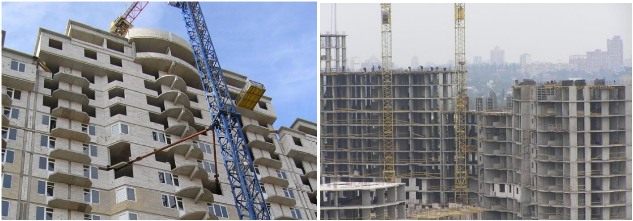
Рисунок 1. Стан будівництва житлових будинків з підземними паркінгами та закладів з обслуговування населення по вул. Вільямса,7 та вул. Ломоносова, 42-50 (III мікрорайон) у м. Києві станом на жовтень 2009 р.
