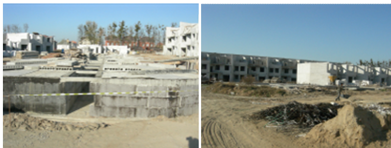
Хід будівництва житлового комплексу з об'єктами соціально-побутової інфраструктури по вул. Леніна, 119 у с. Петропавлівська Борщагівка Києво-Святошинського району Київської області станом середину листопада 2008 року та на середину лютого 2009 року
