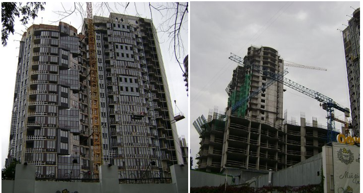
Будівництво житлово-офісного комплексу з вбудованими, прибудованими приміщеннями та підземним паркінгом по вул. Анрі Барбюса, 37/1 у Печерському районі м. Києва станом на 20.09.2010 р.
