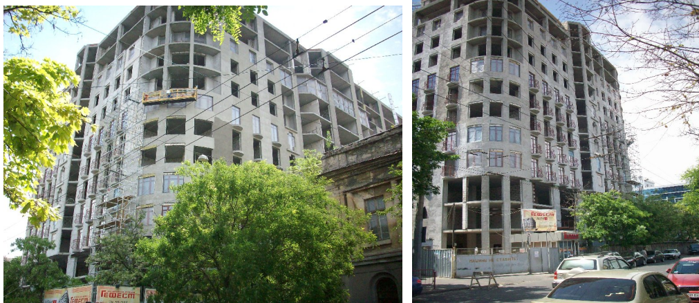
Хід будівництва житлово-торговельного комплексу по вул. Грецькій, 1 у м. Одесі станом 29.05.2009 р.
