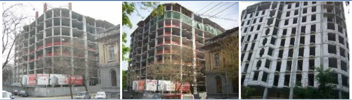
Хід будівництва житлово-торговельного комплексу по вул. Грецькій, 1 у м. Одесі станом (зліва-направо) на 01.03.2008 р., на початок травня 2008 р. та на 22.08.2008 р.
