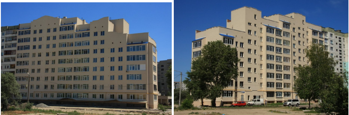
Рисунок 2. Будівництво житлового будинку з офісними приміщеннями по вул. Черепіна, 42-в у м. Сумах станом на червень 2010 року
