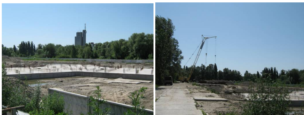
Рисунок 1.3. Будівництво готельно-житлового комплексу з приміщеннями соціально-побутового призначення по проспекту Академіка Глушкова, 926 у м. Києві станом на початок червня 2009 року
