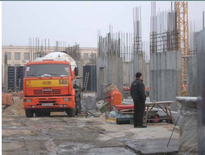
Хід робіт на об'єкті будівництва житлово-офісного комплексу з вбудовано-прибудованими торговельними приміщеннями, закладами громадського харчування та підземною автостоянкою по вул. М. Островського, 40 у м. Києві станом на кінець листопада 2011 року
