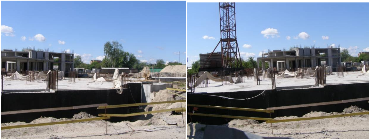
Рисунок 1. Хід робіт на об'єкті будівництва житлового комплексу по вул. Київський шлях, 28 у м. Борисполі станом на 14.05.2009 р.
