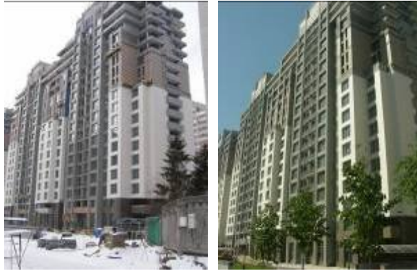
Об'єкт будівництва - ж/б 4 по вул. Професора Підви́соцького у Печерському районі м. Києва станом (зліва-направо): на 08.06.2010 р. та 22.09.2010 р.
