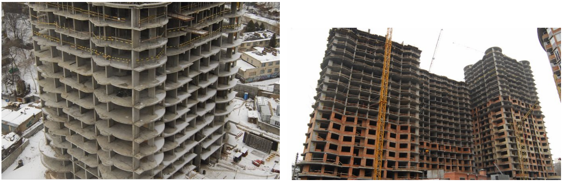
Рисунок 1.1. Будівельні роботи на об'єкті будівництва житлового комплексу по вул. Механізаторів, 2 (ж/к «Ізумрудний») у Солом'янському районі м. Києва станом на січень 2009 р.
