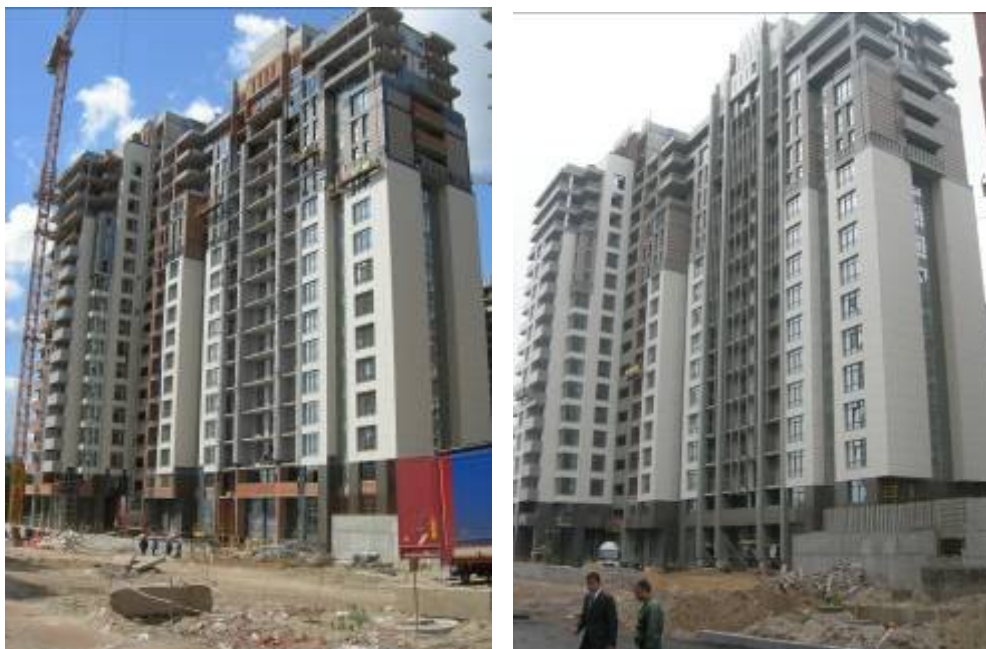
Хід робіт з будівництва ж/б 5 по вул. Професора Підвисоцького у Печерському районі м. Києва станом (зліва-направо): на 18.06.2009 р. та на 03.09.2009 р.
