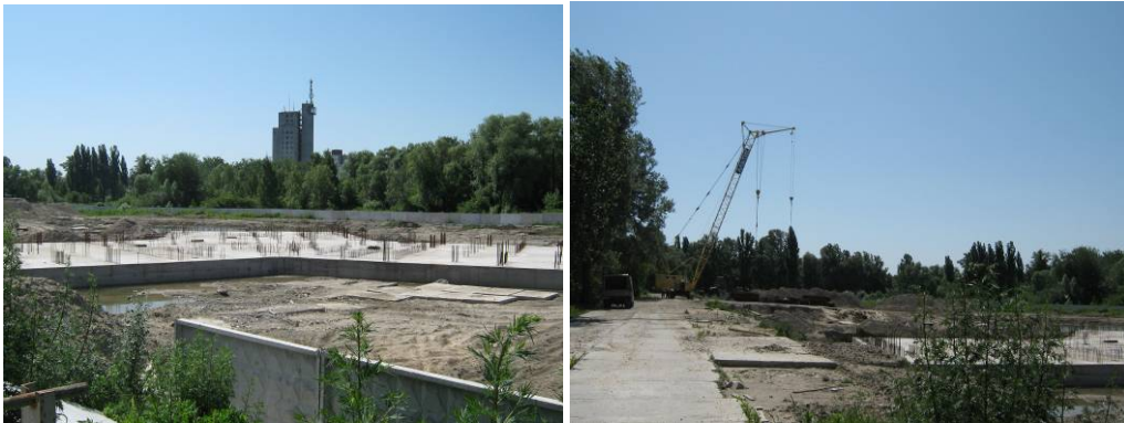
Будівництво готельно-житлового комплексу з приміщеннями соціально-побутового призначення по проспекту Академіка Глушкова, 926 у м. Києві станом на початок червня 2009 року
