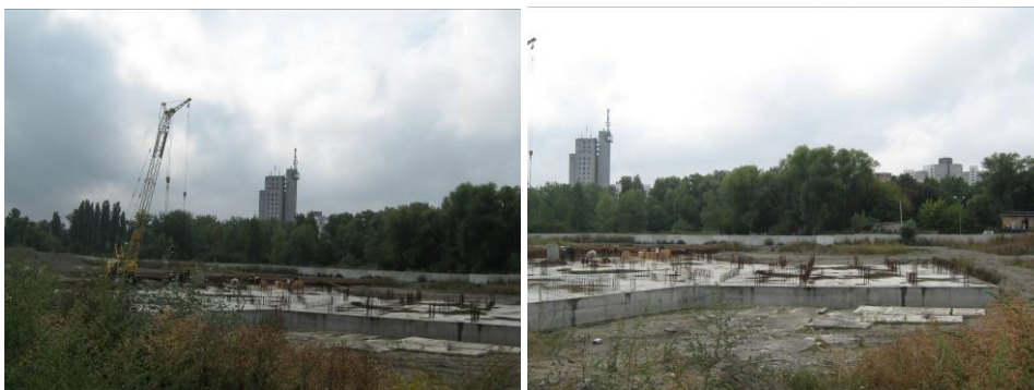
Будівництво готельно-житлового комплексу з приміщеннями соціально-побутового призначення по проспекту Академіка Глушкова, 926 у м. Києві станом на початок вересня 2009 року
