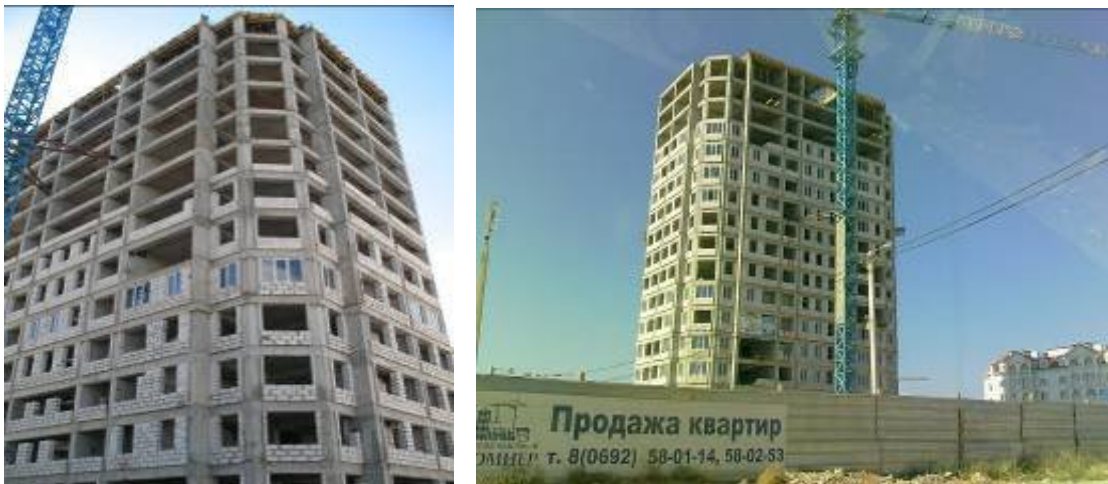
Стан виконання будівельних робіт по корпусу 6 в мікрорайоні «Омега-2а» у м. Севастополі станом на травень 2009 року та на кінець серпня 2009 року.
