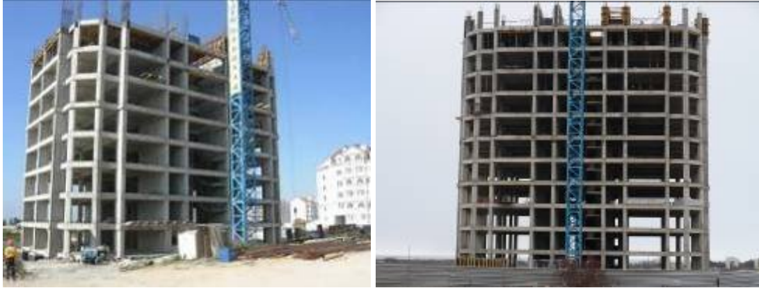
Стан виконання будівельних робіт по корпусу 6 в мікрорайоні «Омега-2а» у м. Севастополі станом на 05.09.2008 р. та на початок листопада 2008 року та станом на лютий 2009 року
