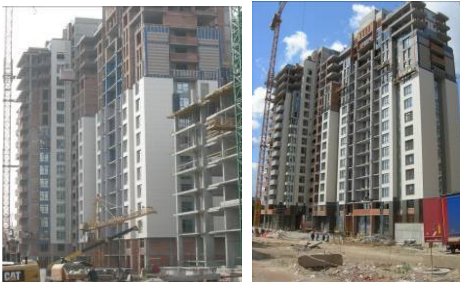
Хід робіт з будівництва ж/б 5 по вул. Професора Підвисоцького у Печерському районі м. Києва станом (зліва-направо): на 12.03.2009 р. та на 18.06.2009 р.
