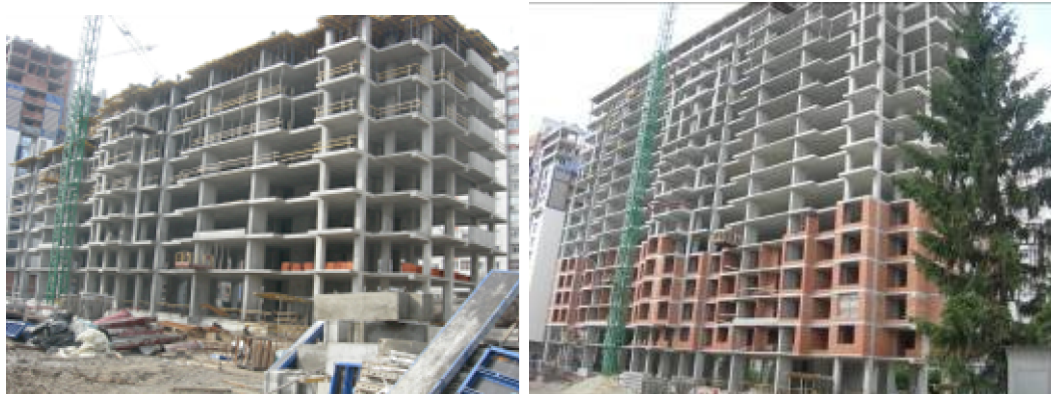
Хід робіт з будівництва ж/б 4 по вул. Професора Підвисоцького у Печерському районі м. Києва станом (зліва-направо): на 12.03.2009 р. та на 18.06.2009 р.
