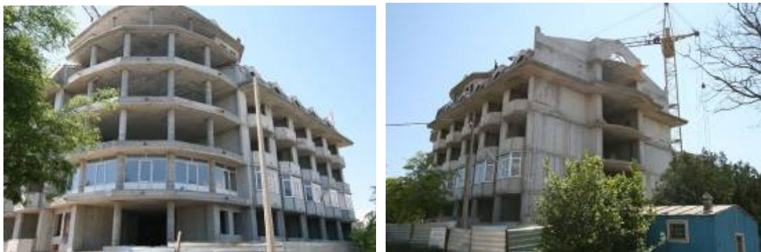
Рисунок 1.4. Фото будівництва Малого готелю по вул. Франка, 11 у м. Євпаторії станом на червень 2009 р.
