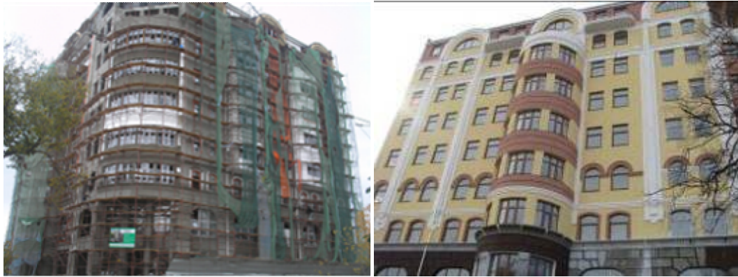
Хід робіт на об'єкті будівництва по вул. Баглікова у м. Алушті станом на початок листопада 2008 року та на середину лютого 2009 року
