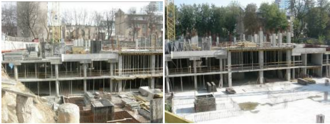
Хід робіт з будівництва багатоповерхового житлового будинку з вбудовано-прибудованими приміщеннями громадського призначення та підземного паркінгу по вул. Білоруській, 36-а у Шевченківському районі м. Києва станом на кінець березня 2009 року та на вересень 2009 року
