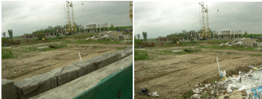
Рисунок 2. Стан будівництва житлових будинків у с. Чайці по вул. Коцюбинського, 29, 30 Київської області на 20.05.2010 р.
