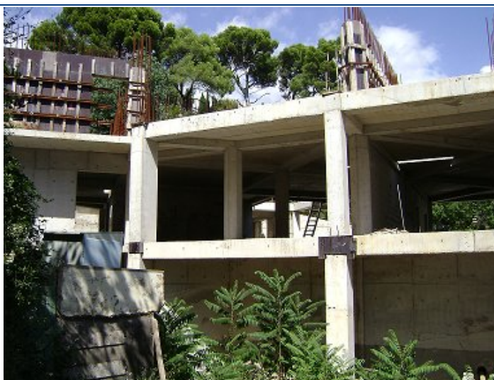
Хід будівництва рекреаційного комплексу по вул. Луговського в смт. Сімеїз станом на 27.08.2010 р.
