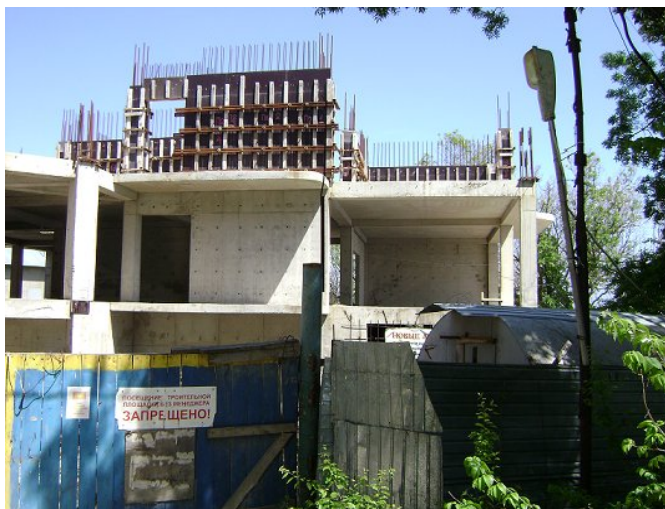
Хід будівництва рекреаційного комплексу по вул. Луговського в смт. Сімеїз станом на 06.05.2010 р.
