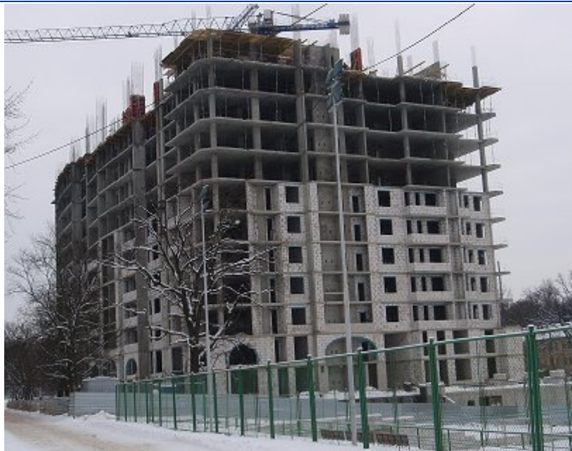
Стан будівництва житлового комплексу по вул. Фронтівій, 3 у м. Харкові станом на 18.01.2011 р.
