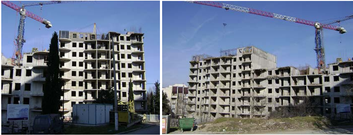
Рисунок 1.4. Стан будівництва житлового комплексу, який складається з житлових будинків (блок «Б1», блок «Б2», блок «Г») та підземних автостоянок (блок «А», блок «В») по вул. Жовтневій в районі житлового будинку №32 у м. Алушті станом на 09.03.2011 р.
