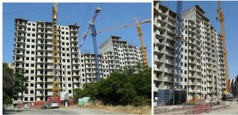
Рисунок 1.5. Стан будівництва житлового комплексу, який складається з житлових будинків (блок «Б1», блок «Б2», блок «Г») та підземних автостоянок (блок «А», блок «В») по вул. Жовтневій в районі житлового будинку №32 у м. Алушті станом на середину липня 2011 року.
