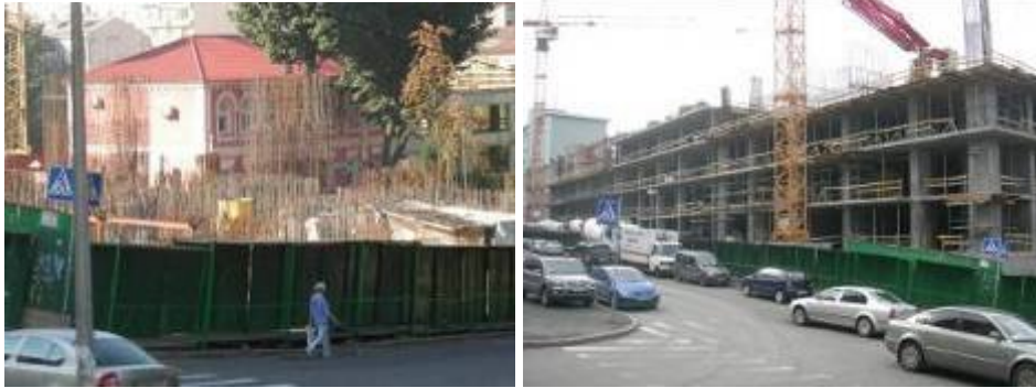
Будівельні роботи на об'єкті будівництва, обмеженого вулицями Предславинською, Ульянович та Червоноармійською станом на 21.08.2008 р. та 31.03.2009 р
