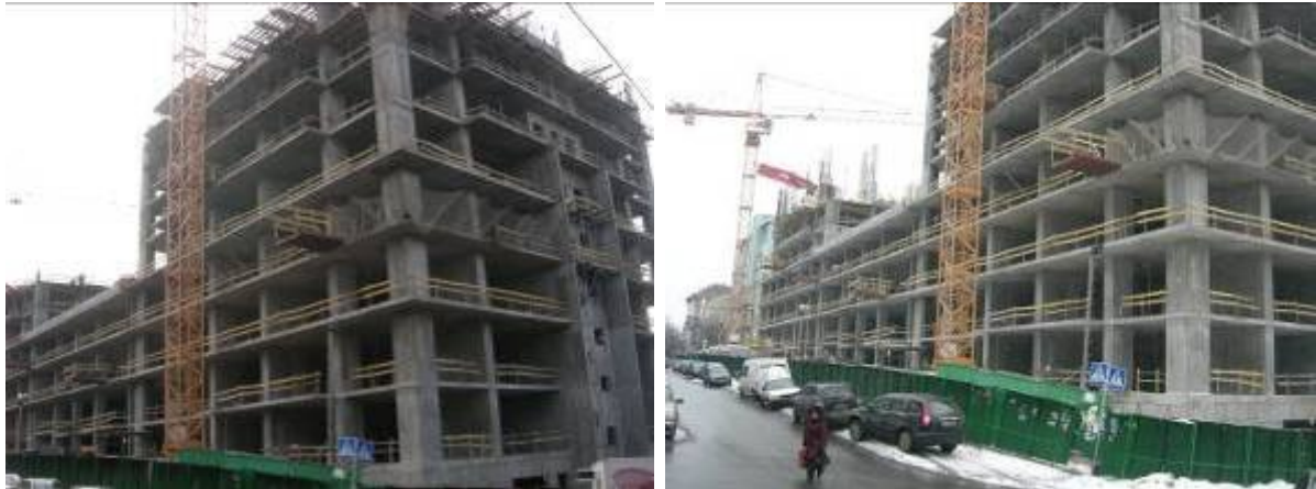
Будівельні роботи на об'єкті будівництва, обмеженого вулицями Предславинською, Ульянович та Червоноармійською станом на 17.11.2009 р. та станом на середину березня 2010 р.
