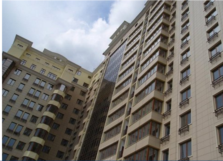
Хід будівництва житлового комплексу по вул. Фронтівій, 3 у м. Харкові станом на кінець квітня 2012 року
