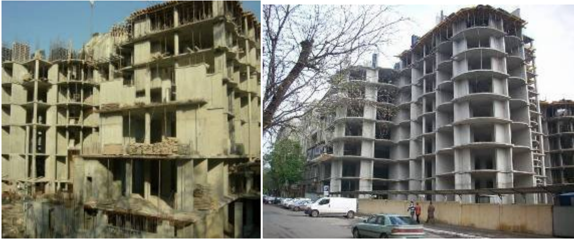
Будівельні роботи на об'єкті будівництва офісно-житлового комплексу по вул. Канатній, 27 станом на (зліва-направо) 29.02.2008 р. та кінець квітня 2008 р.
