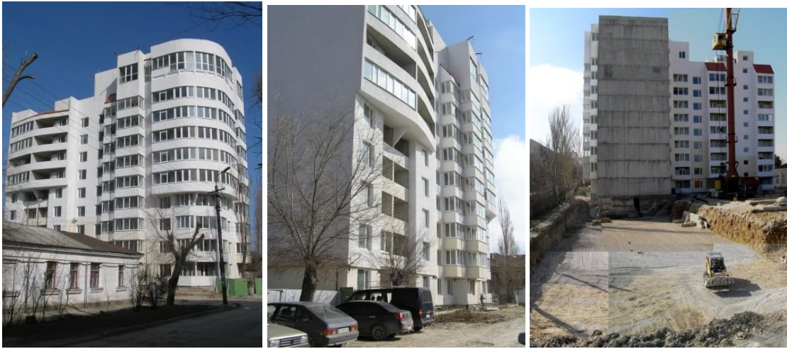
Рисунок 1. Будівельні роботи по вул. Вересаєва, 12 у м. Феодосії станом на лютий 2010 року
