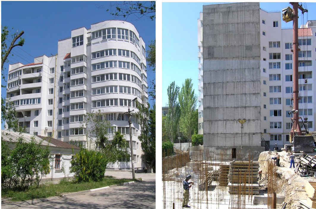
Рисунок 2. Будівельні роботи по вул. Вересаєва, 12 у м. Феодосії станом на травень 2010 року
