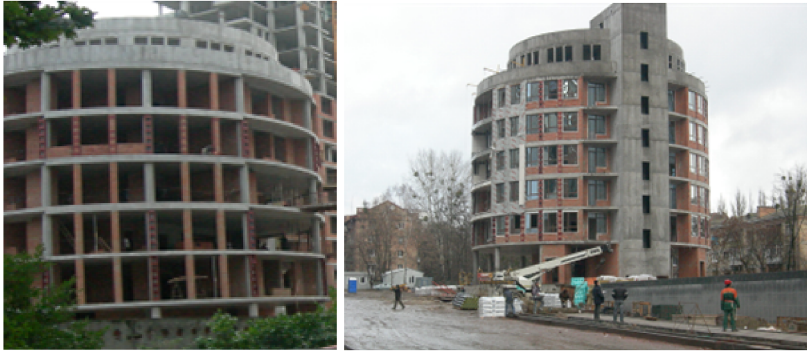
Хід робіт з будівництва ж/б 1 по вул. Професора Підвисоцького у Печерському районі м. Києва станом (зліва-направо): на 03.09.2009 р. та на 19.11.2009 р.
