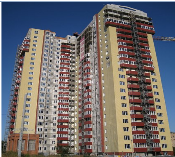
Хід робіт на об'єкті будівництва по вул. 23 Серпня (в районі буд. 31) у м. Харкові станом на 21.08.2009 р.
