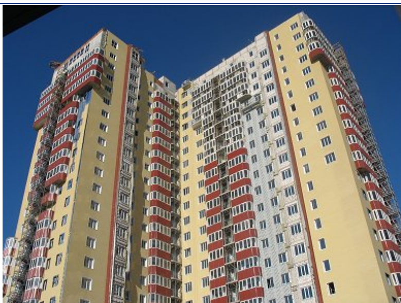
Хід робіт на об'єкті будівництва по вул. 23 Серпня (в районі буд. 31) у м. Харкові станом на 27.10.2009 р.
