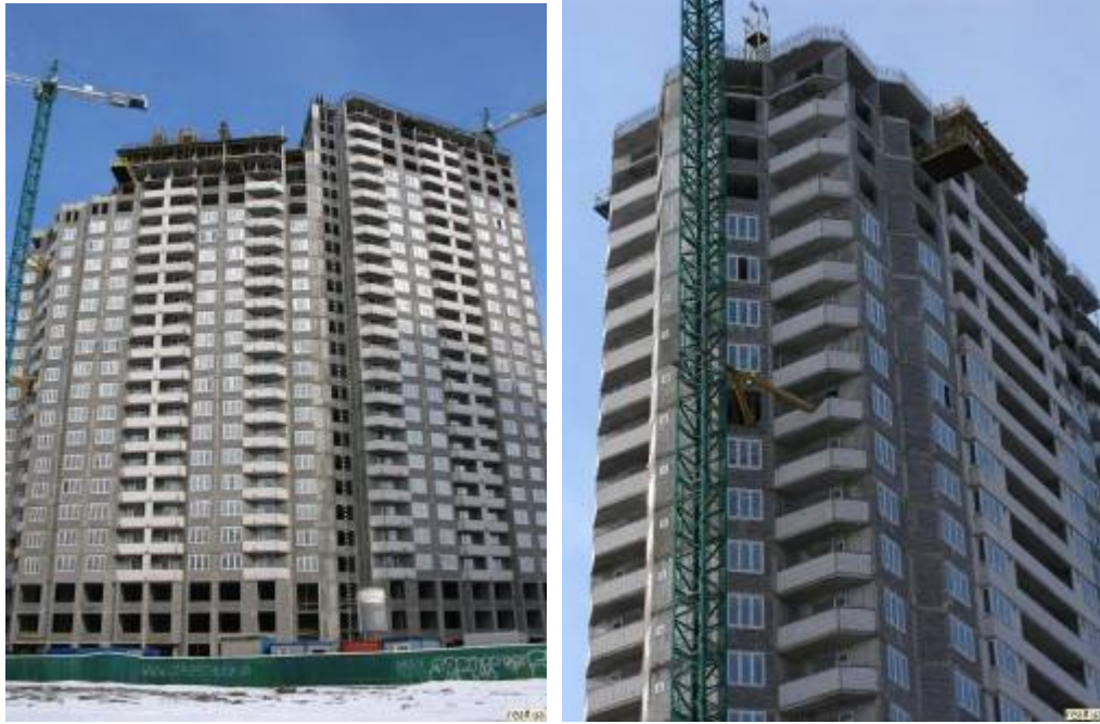
Рисунок 1. Стан будівництва житлового будинку по вул. О. Пчілки у 4-му м/н ж/м Позняки на березень 2010 р.
