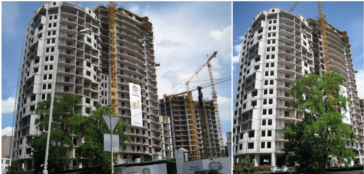
Будівництво житлово-офісного комплексу з вбудованими, прибудованими приміщеннями та підземним паркінгом по вул. Анрі Барбюса, 37/1 у Печерському районі м. Києва станом на 08.06.2009 р.
