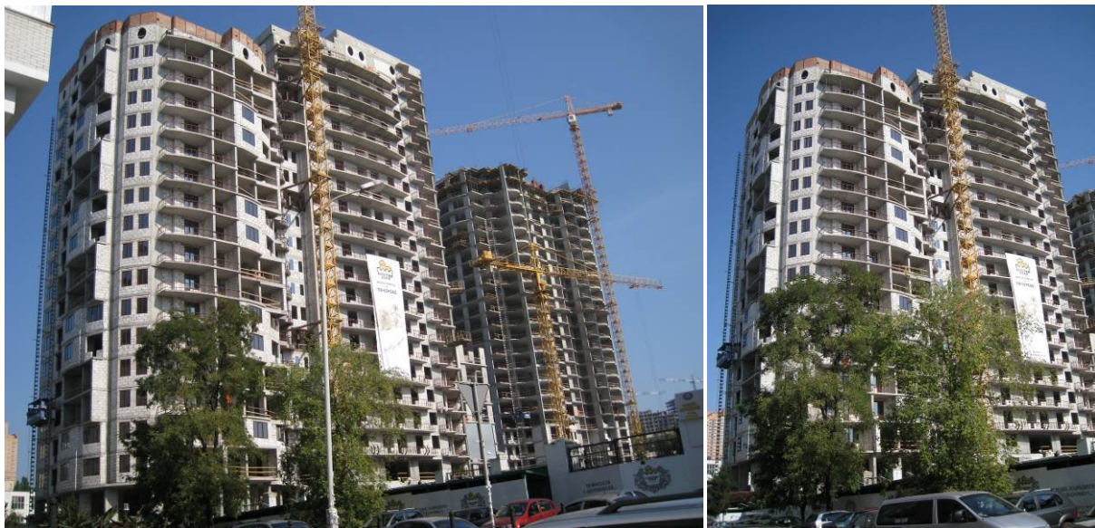
Будівництво житлово-офісного комплексу з вбудованими, прибудованими приміщеннями та підземним паркінгом по вул. Анрі Барбюса, 37/1 у Печерському районі м. Києва станом на 23.09.2009 р.
