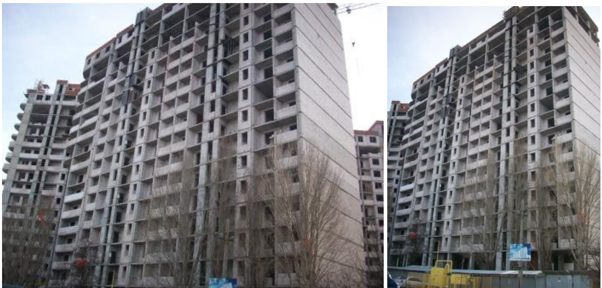
Рисунок 1. Будівництво житлового будинку по вул. Ак. Корольова, 5/2 у м. Одесі станом на 05.03.2010 року
