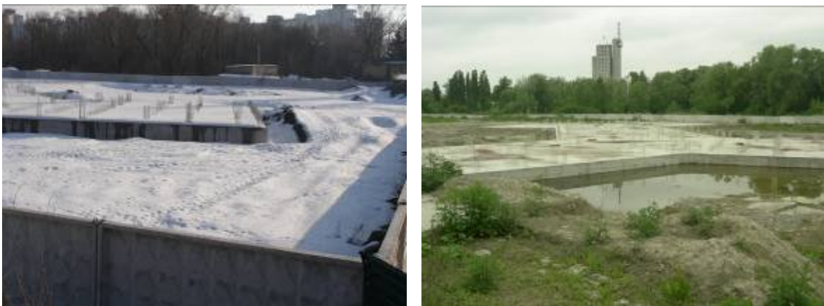
Будівництво готельно-житлового комплексу з приміщеннями соціально-побутового призначення по проспекту Академіка Глушкова, 926 у м. Києві станом на березень 2010 року та на серпень 2010 року.
